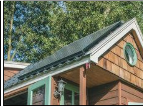
Figuur 3 Zonnepanelen om de kleine gebouwtjes van stroom te voorzien voor opladen laptop/telefoon
